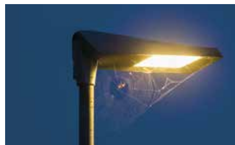
Verschmutzung durch Insekten und Spinnen an einer LED-Leuchte vermindert die Beleuchtungsqualität.
