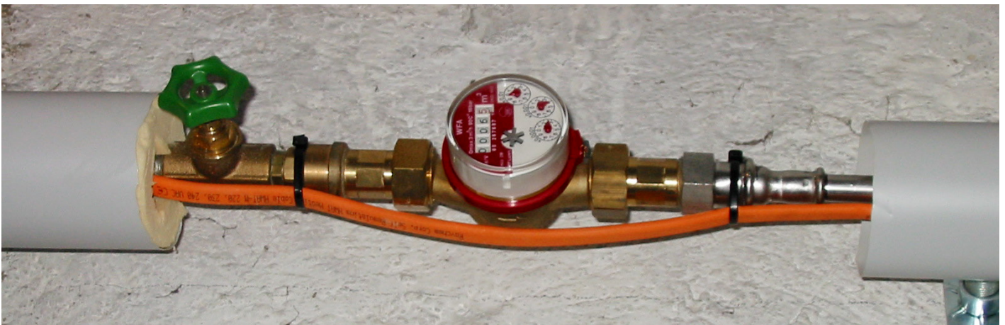
Fig. 5: nonostante il calore del cavo riscaldante, a causa delle notevoli perdite termiche si creano un «punto di prelievo freddo» e forti perdite. La coibentazione deve essere completata, lasciando due aperture per la manopola e il contatore (foto J. Nipkow)
