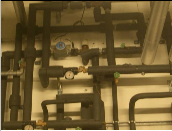
Bild 9 Haustechnik im UG
