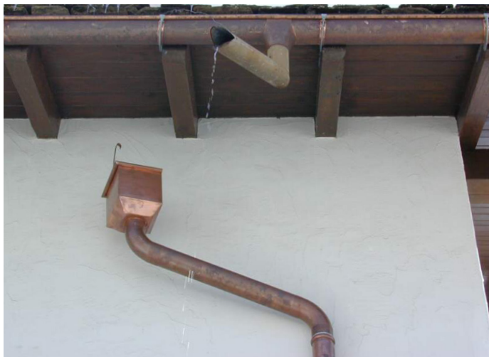
Abb. 9: Fallrohr-Frostschutz. Quelle: C. U. Brunner, Zürich
