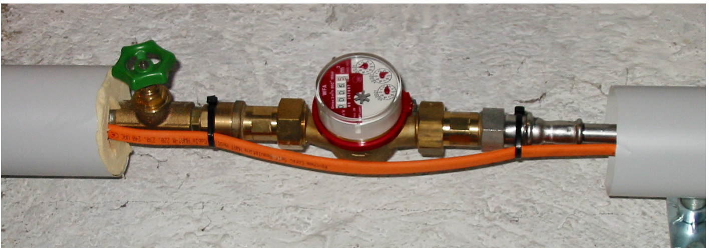
Abb. 5: Trotz heissem Heizband – aufgrund der erhöhten Wärmeverluste – entstehen ein «kalter Zapfen» und grosse Verluste. Die Wärmedämmung muss durchgezogen werden, mit Ausschnitten für Handrad und Zählerkopf. Foto J. Nipkow
